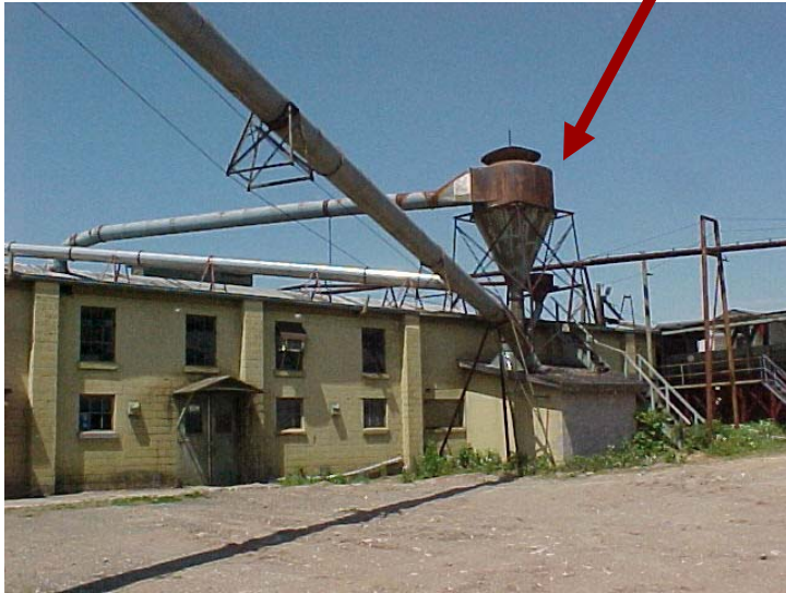
T&R Mill Cyclone
